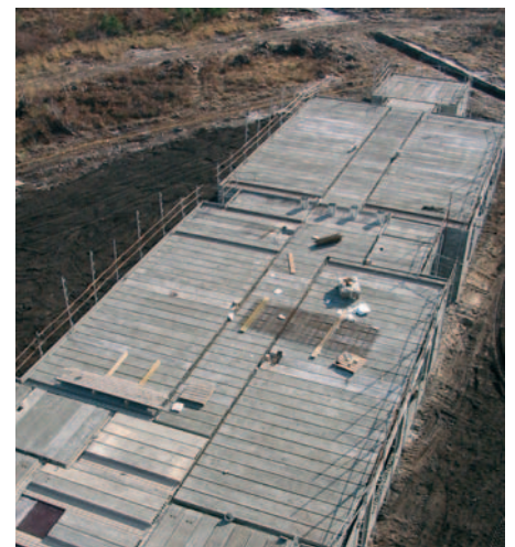
ALIDAL EN TOITURE-TERRASSE (COLL. MARCHEPRIME 33)
