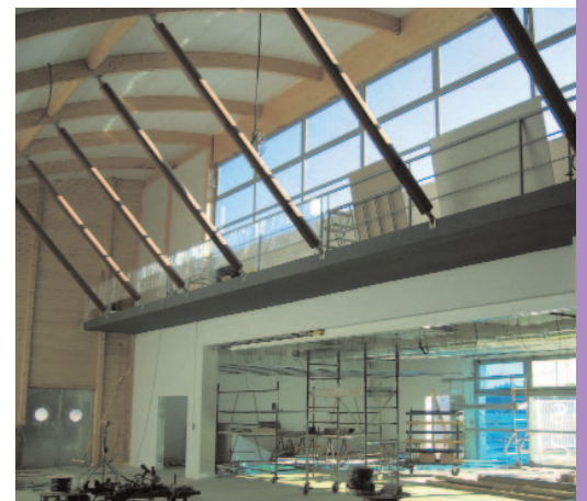
Salles de restauration pour le Grand Hall, Tours (37) : vue intérieure. Architecte : Bertrand Penneron
