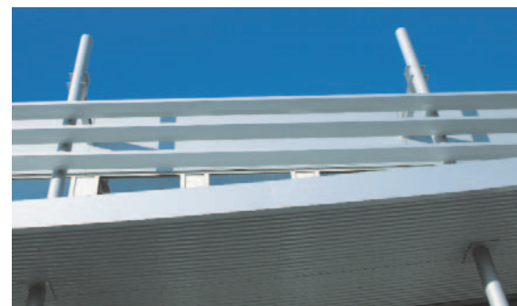
Maintenance lourde du Lycée Grandmont (amélioration du clos, du couvert et travaux de sécurité) . Tours : détail de la façade sud du bâtiment restaurant scolaire.
